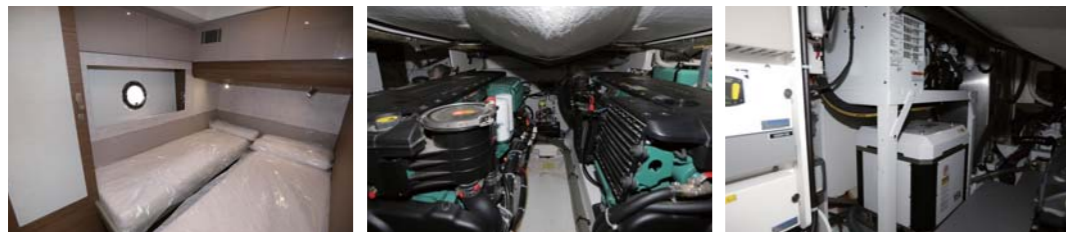
クルーやゲスト用のツインルーム。エンジンはVOLVO PENTA IPS600を2基掛け。大型の発電機やジャイロも装備。アフトギャレーにはBBQグリルがある。
