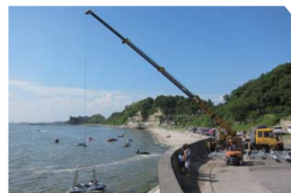
揚降クレーン完備
