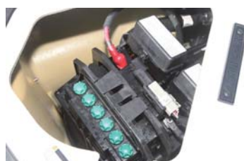
取り外しが便利な位置にあるバッテリー。
